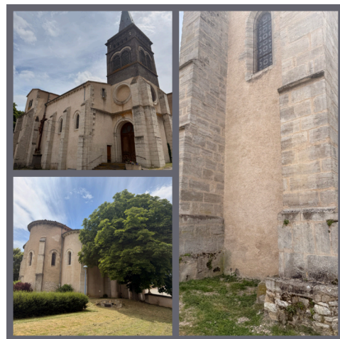
Les désordres structurels se situent sur la voûte nord de l'édifice accentués par le retrait gonflement d'argile (à droite de la photo).
